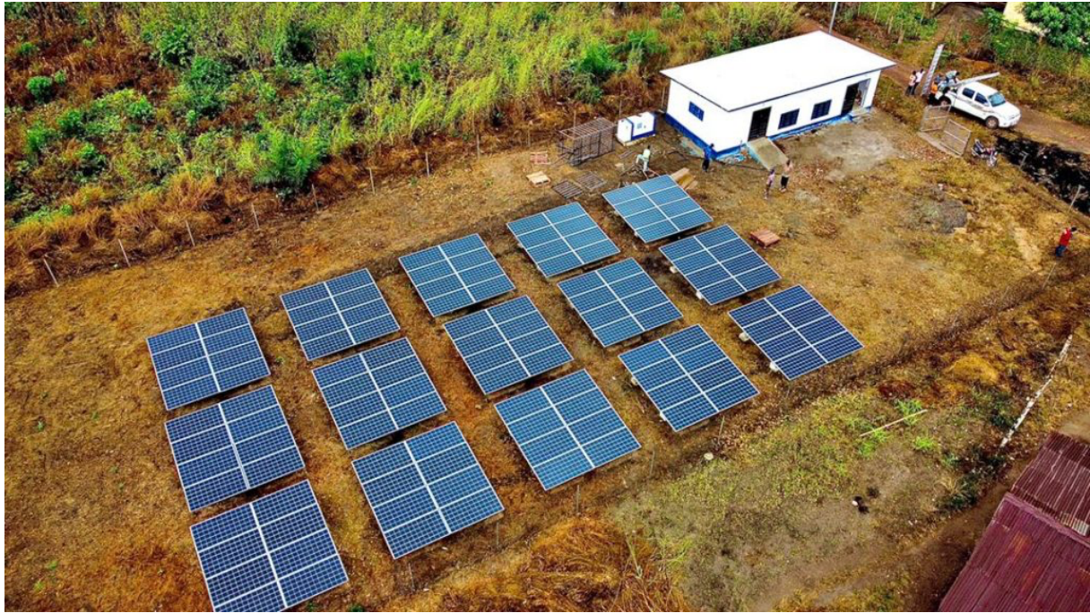
Figure 1: Mini-centrale solaire PV construite par Energicity Corp en Sierra Leone
