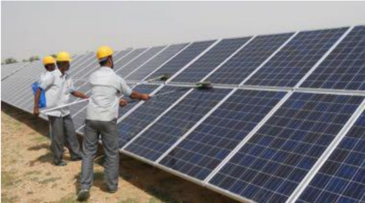
Figure 1: Mini-centrale solaire PV construite par Paras Energy & Natural Resources Ltd.
